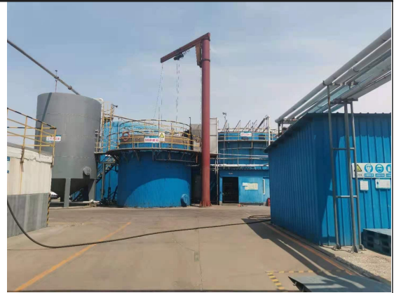
厂区污水处理站 2
