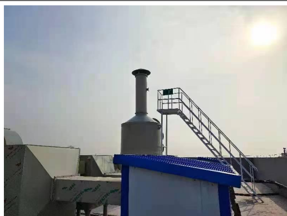
废气处理设施和排气筒 DA009
