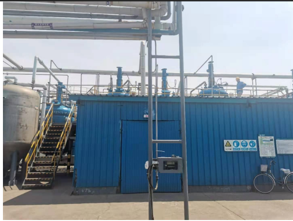
厂区污水处理站 1
